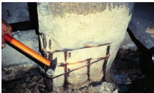
(b) Concreto reforçado com aço (10 anos).
