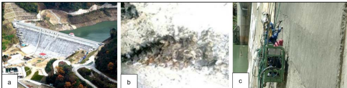
Figura 2.7: Barragem Mitaka (Japão) (a) visão geral, (b) superfície de concreto severamente danificada por fragmentações, fissuras e infiltrações e (c) reparo sendo executado com a utilização de SHCC projetado (ECC APPLICATIONS, 2017).
