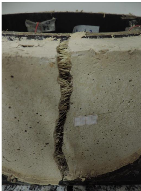
Figura 6.17 – Bordas da região fissurada no momento da desmontagem do ensaio de retração restringida (amostra 3).
