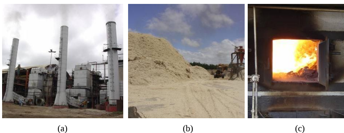
(a) (b) (c) Figura 3.2 – Vista externa da caldeira da Santa Cruz (a), vista frontal das caldeiras (b) e depósito das cinzas nas dependências da usina (c).
